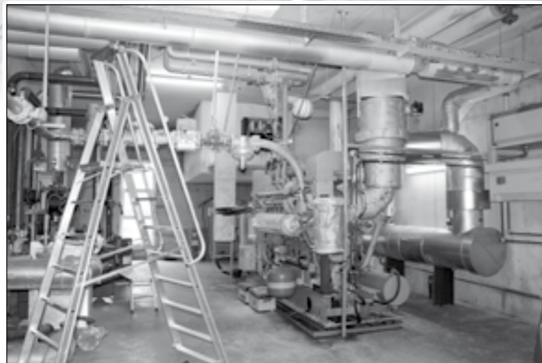
Im Blockheizkraftwerk wird Strom und Wärme erzeugt.
